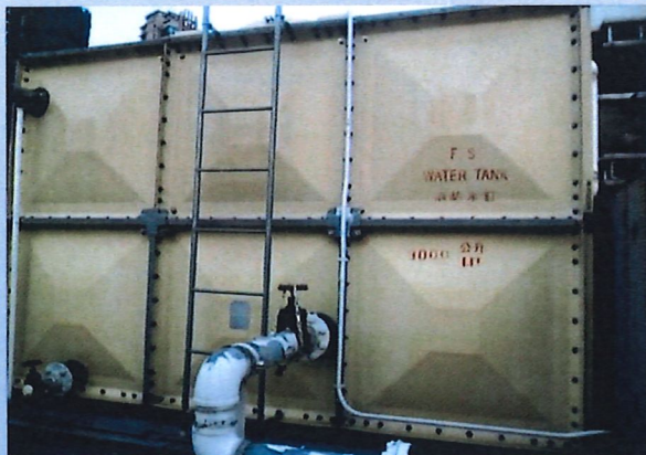
9,000公升消防水缸
